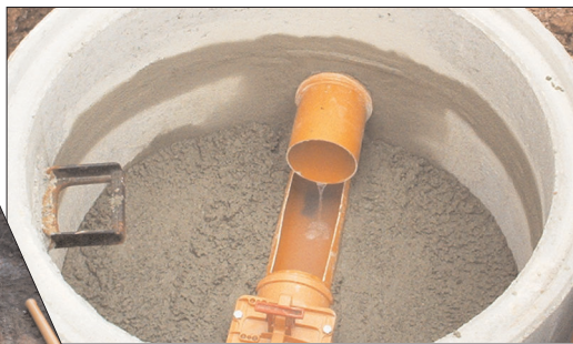
Wo es möglich ist, werden die Kleinkläranlagen nach sachgerechter Entleerung aufgefüllt und durch sie dann die neuen Anschlüsse geführt. Fotos (2): WAZV Apfelstädt-Ohra
